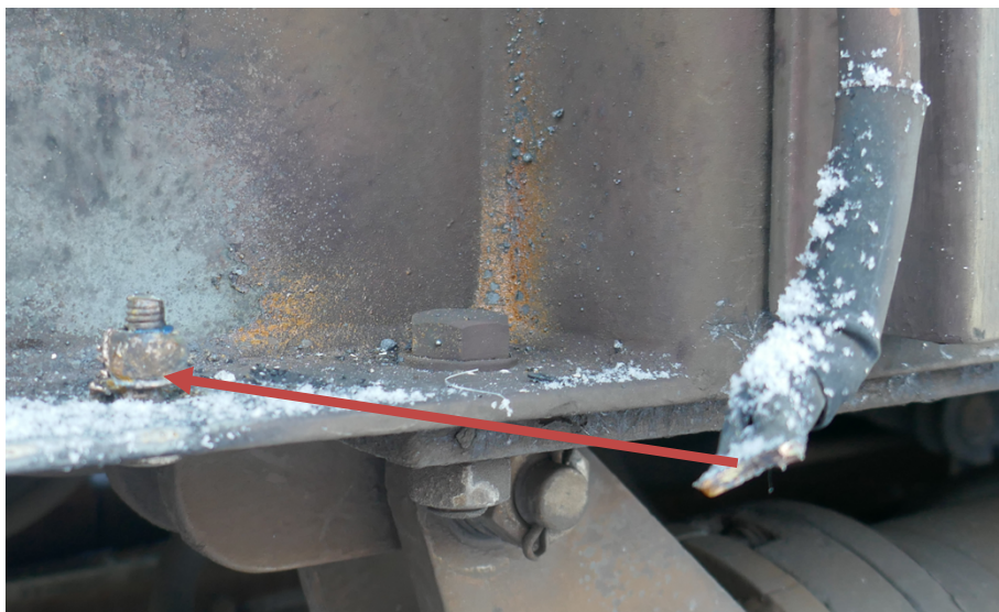
Abbildung 8: Abgerissener Kabelschuh, Lichtbogenspuren auf der Befestigungsschraube.
