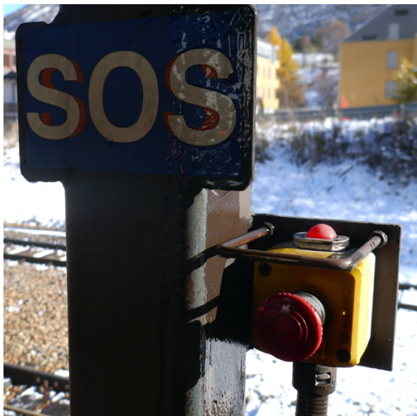
Abbildung 17: Beispiel eines Notfallknopfs an einem Verladewagen.
