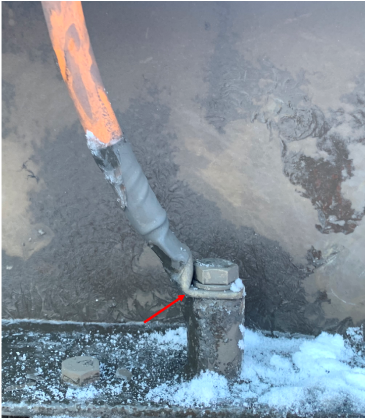
Abbildung 24: Einknickter Kabelschuh (Aufnahme auf einem Vergleichsrampenwagen).
